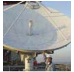
衛星通信設備
