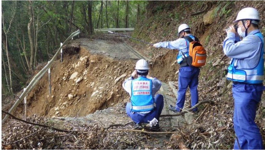
▲ 被災状況調査の様子
