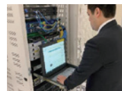
サーバーで外交情報通信システムのメンテナンス
