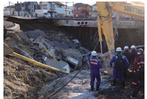
埼玉県八潮市で発生した道路陥没に伴う緊急災害対策派遣隊(TEC-FORCE)活動の様子
