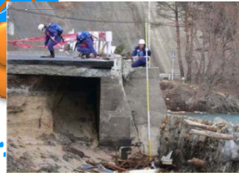
道路被災状況の調査
